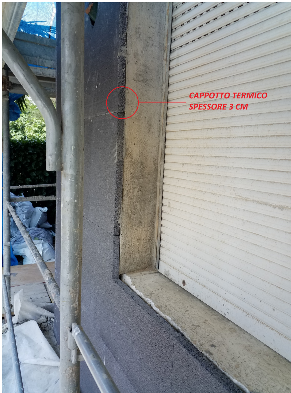
Figura 4. Errore n. 2: utilizzare pannelli isolanti di spessore insufficiente
