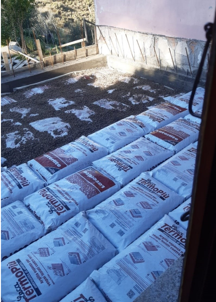
Figura 4- Pavimento contro terra con “vespaio” in argilla espansa. Posa dell’argilla espansa al livello delle travi di fondazione, su di uno strato di tessuto non tessuto.
