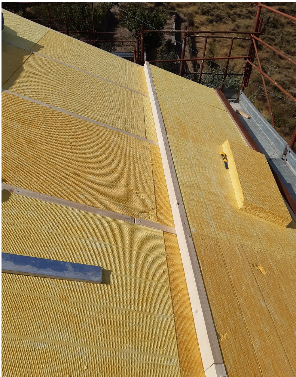
Figura 10 - Tetto ventilato - Doppio strato incrociato di pannelli in lana di vetro, posti in opera tra i listelli di contenimento
