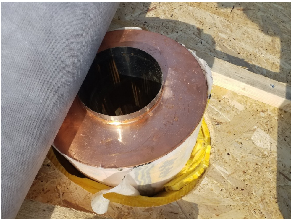
Figura 11 - Tetto ventilato - Passaggio per canna fumaria. Si nota il risvolto della membrana freno vapore.
