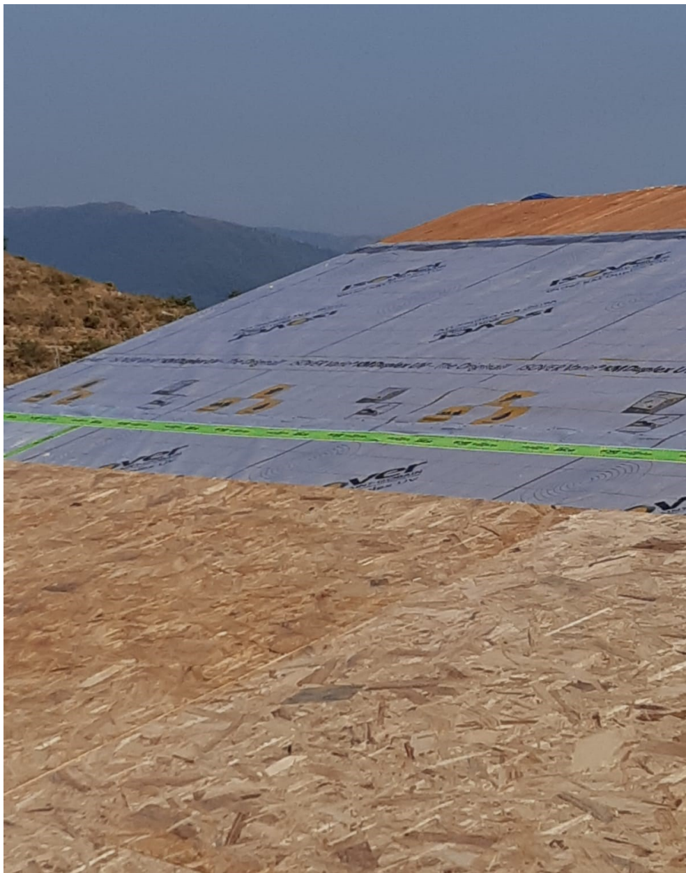
Figura 9 - Tetto ventilato - Assito in perline di abete, membrana freno vapore e primo strato di pannelli OSB
